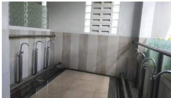
Gambar 4.12. tempat wudhu laki-laki pada masjid At-taqwa
