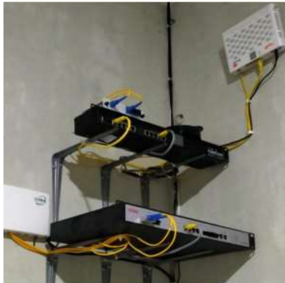
Gambar 2 Pemasangan Routerboard dan OLT
