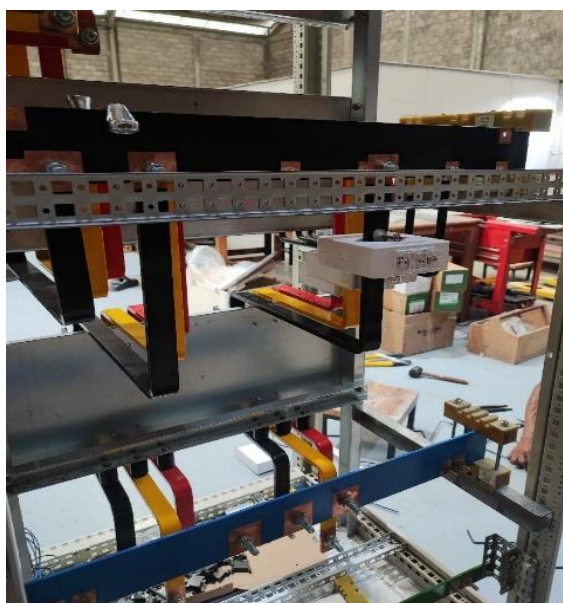
Gambar 2. Instalasi Busbar Tembaga dengan Kode Warna Fasa
