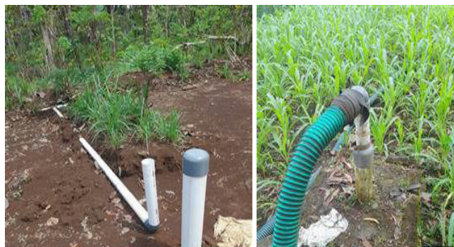
Gambar 4. Terminal Air a. Pipa Distribusi Air, b. Selang Fleksibel Petak Sawah
